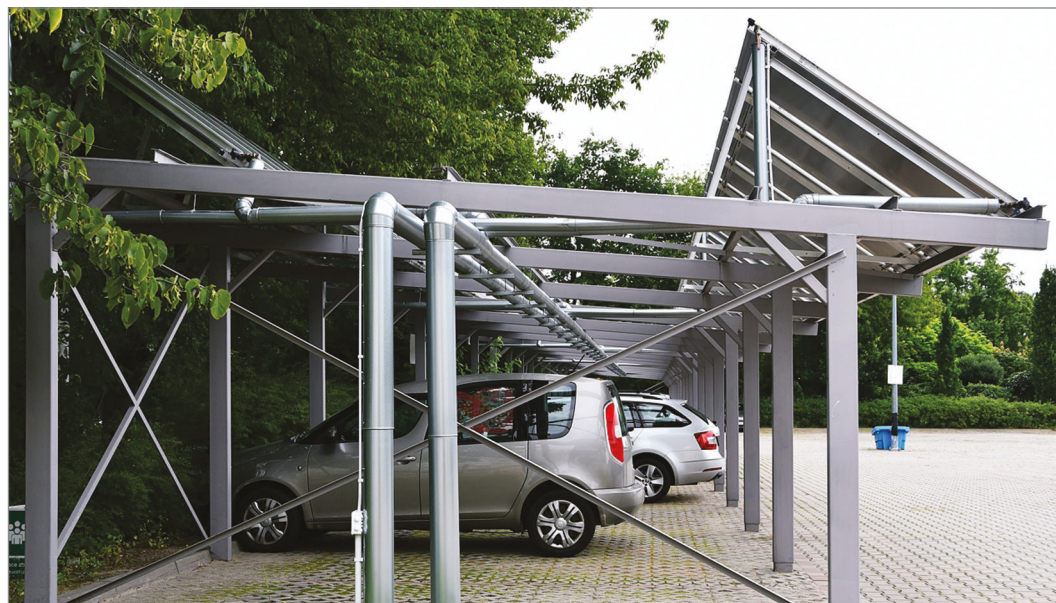
Konstrukcja wsporna. Panele fotowoltaiczne przy budynku GUS
