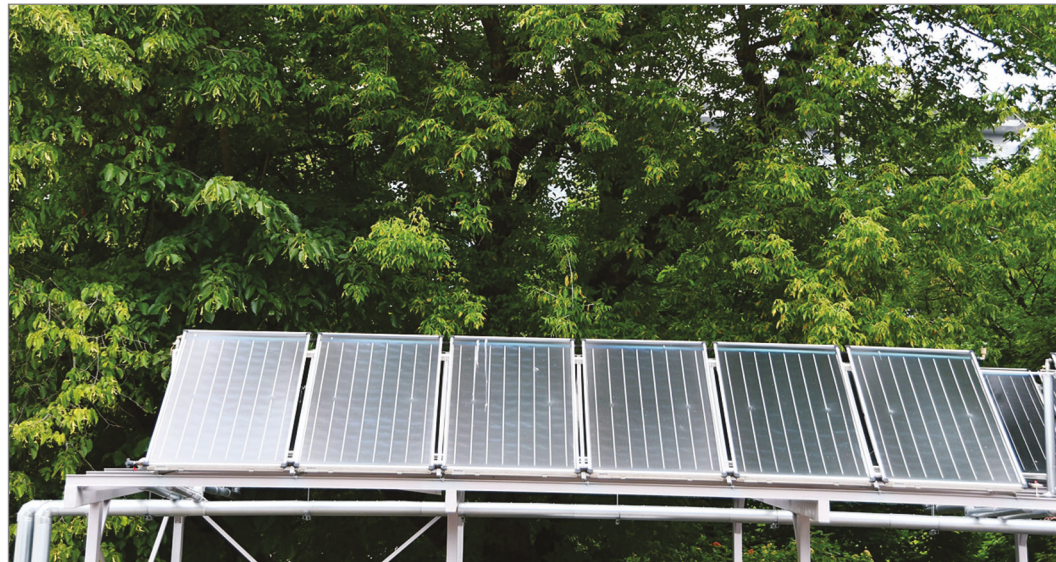
Panele fotowoltaiczne przy budynku GUS
