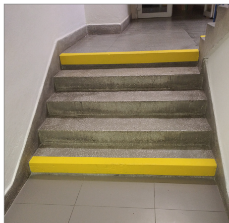
Kontrastowe oznakowanie schodów w budynku US Warszawa
